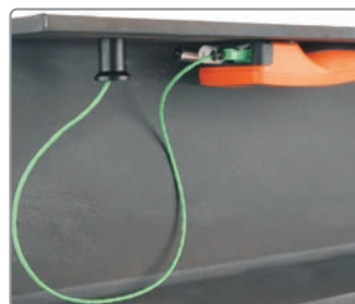
Surveillance à distance des paramètres climatiques
